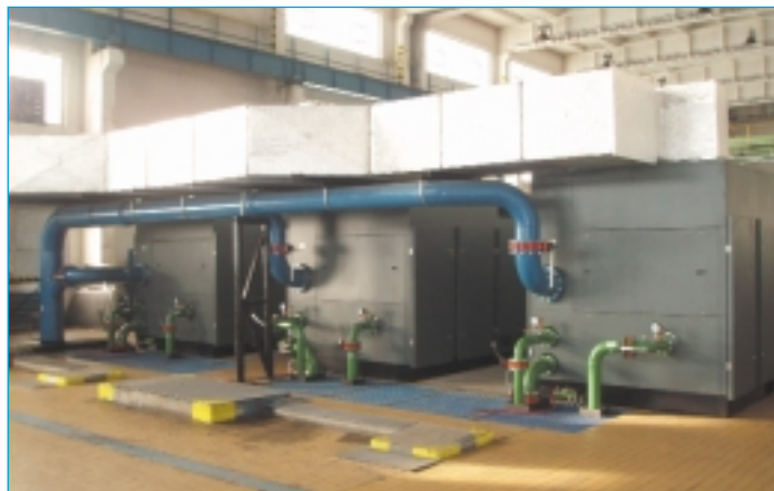
Kompresorová stanice na dole ČSA
