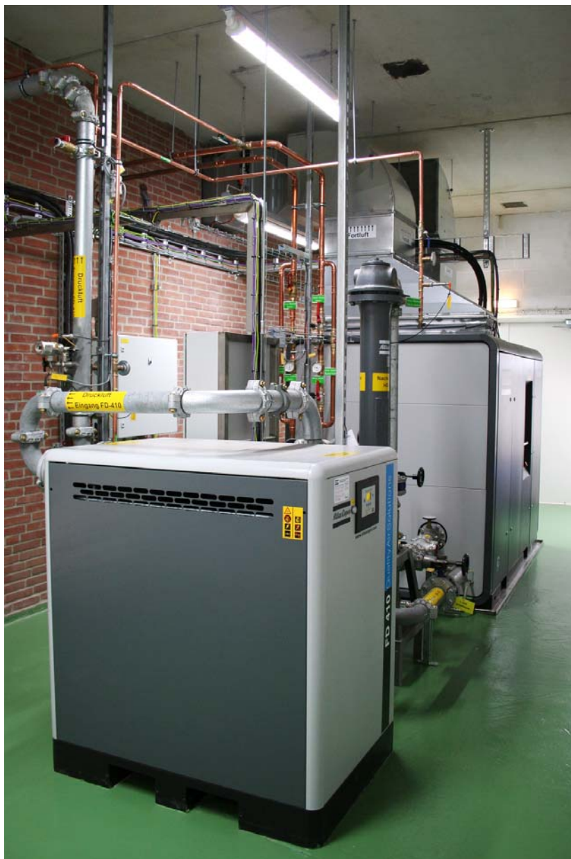
Blick in die Station mit drehzahlregelm Schraubenkompressor ZR 132 VSD (hinten), von dem aus die beiden kühlwasserführenden Kupferrohre in der Bildmitte nach oben und dann durch die Ziegelsteinwand links zum Wärmetauscher führen, sowie Nachkühler („Zylinder“ in der Mitte) und Kältetrockner (vorne). (Bild: Atlas Copco Kompressoren und Drucklufttechnik GmbH)
