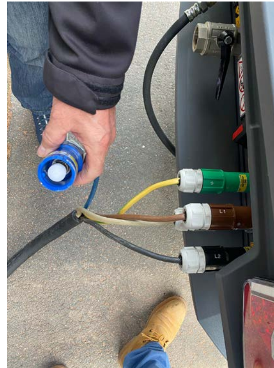
Powerlocks auf 125A-Steckdose
