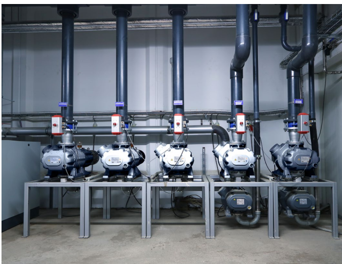
Bombas de reforço DRB
